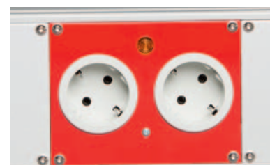
EDV-Steckdoseneinsatz mit roter Frontplatte (nicht über Not-Aus abgesichert)
